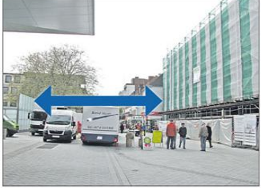
Der Pfeil zeigt, wie weit der Zugang zur Tiefgarage und das Stadthaus voneinander entfernt sind.
